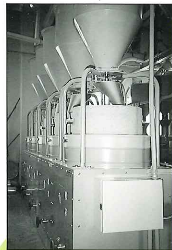
石臼製粉機工場設置例
